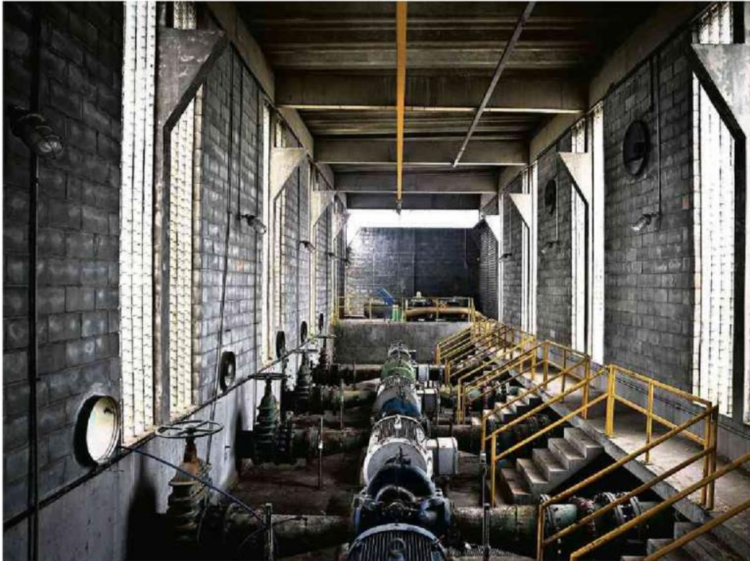
Reservatório em Barueri, onde a Sabesp prepara "piloto" de mini-hidrelétrica para reduzir custos com energia elétrica
