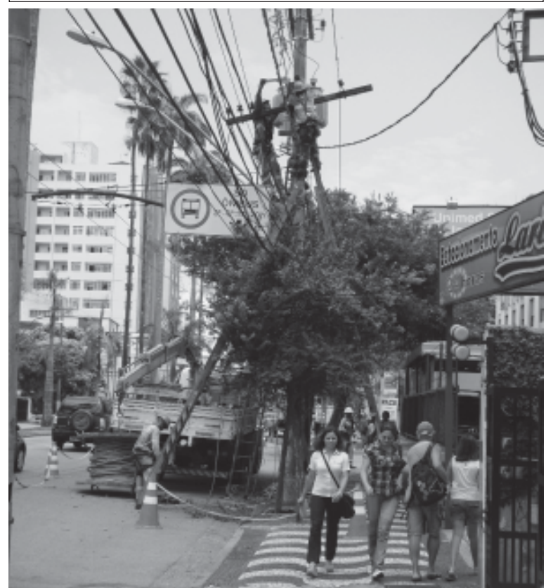
Pedestres passando e correndo risco de serem atingidos por materiais
